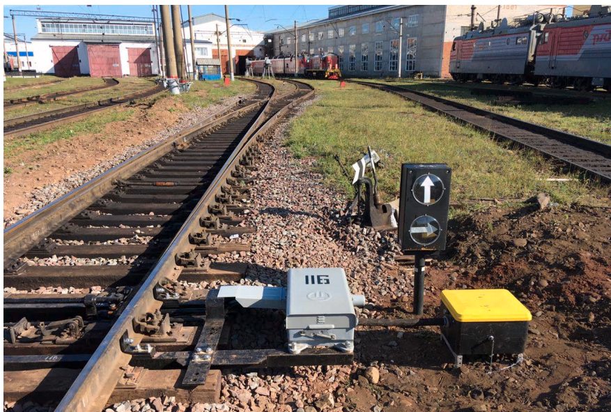
Рис. 1. Стрелочный электропривод СП-6М с управляющей аппаратурой системы Ctrl@Point в депо «Братское»
